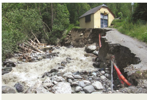
Route détruite après la crue de juin 2013 à Luz (© C-PRIM)
