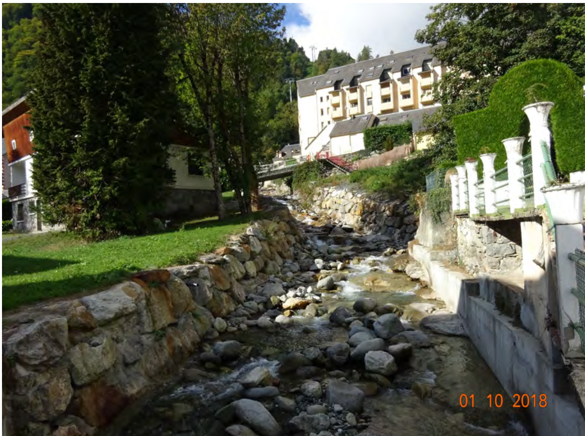
Photo n° 22 : Vue 18 - Cambasque, vue vers l'amont au pont de la rue de Brau (date de prise de vue 01/10/2018)
