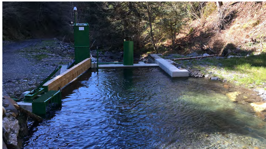
Photo n° 1 : Exemple de la prise d'eau de Gazost équipée d'une grille coanda et principe de fonctionnement
