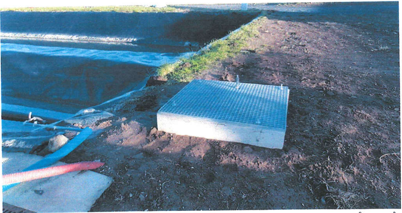
2 - Vanne de séparation eaux pluviales
