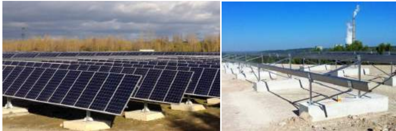
Structures fixes sur longrines béton (centrales URBASOLAR de Lavernose-Lacasse et Gardanne)
