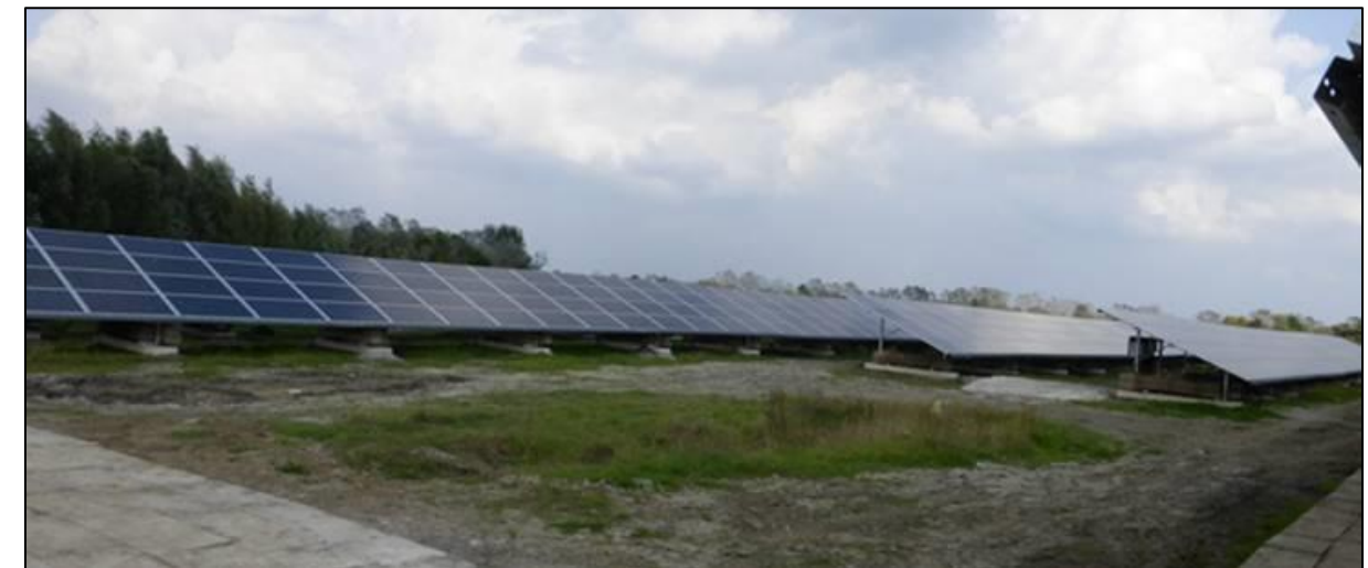
Figure 13 : Exemple de panneaux photovoltaïques au sol
