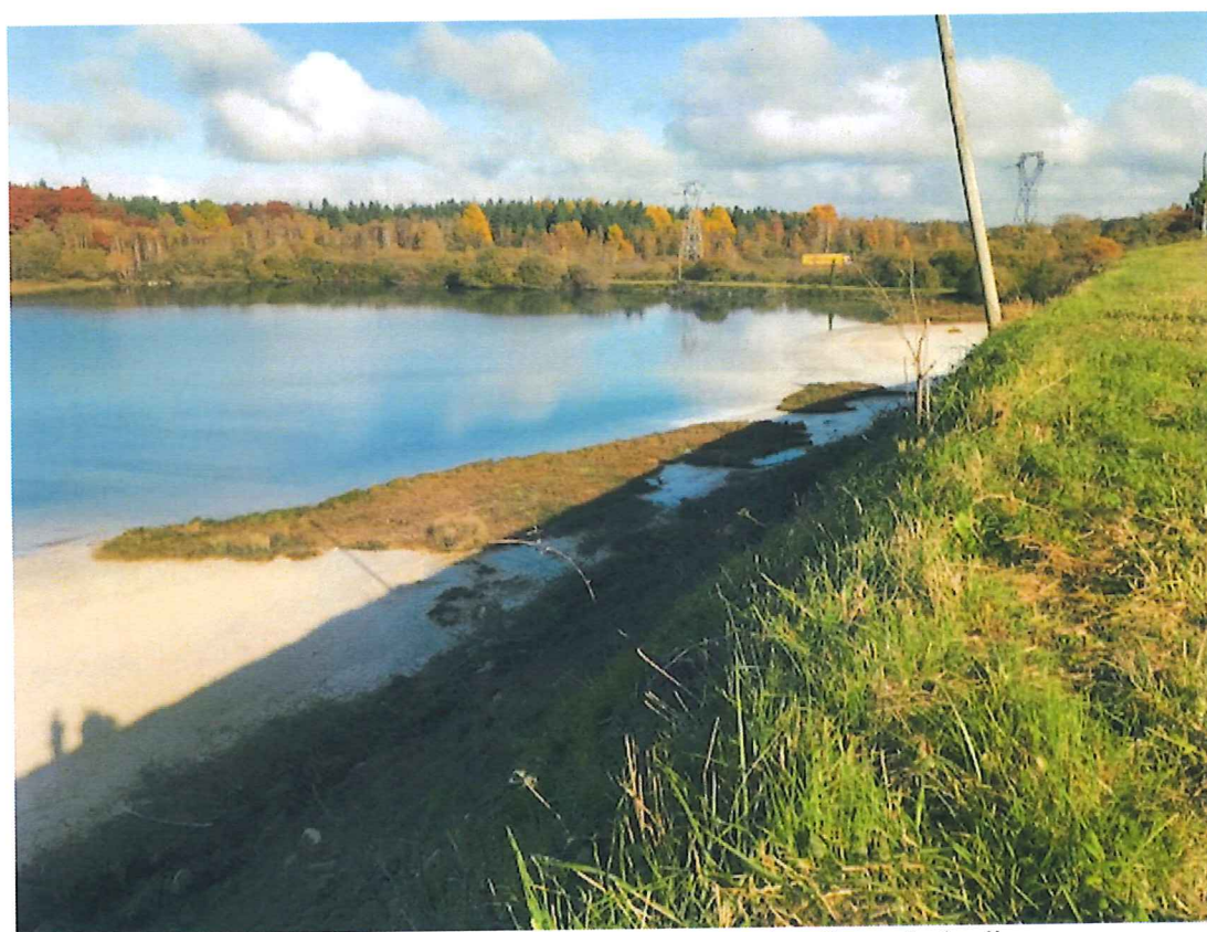
Lagune aval sur le cours de la Baïse Darré et flanc de la digue
