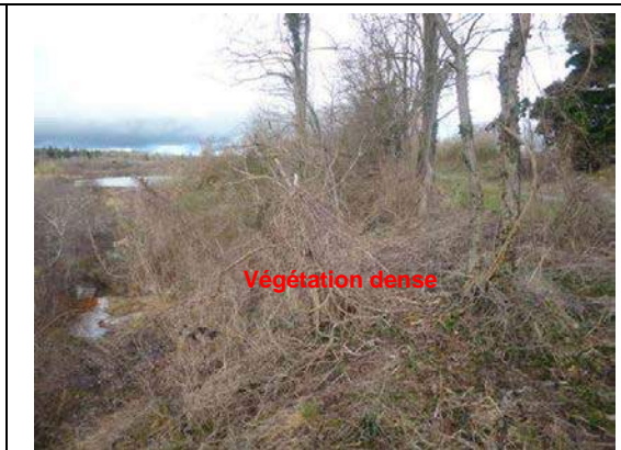
Vue de la végétation abondante sur le talus aval depuis la crête
