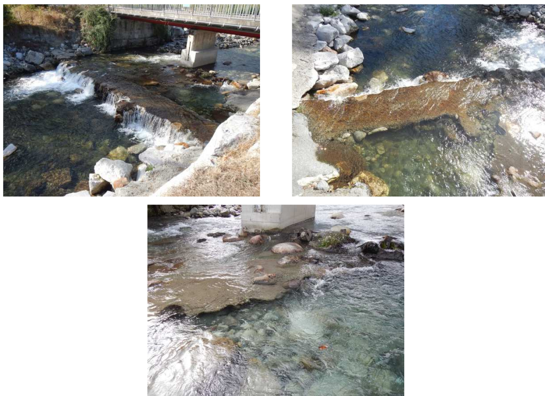
Figure 52 : Seuil du pont interzone + Erosion entre le seuil et la pile de pont
