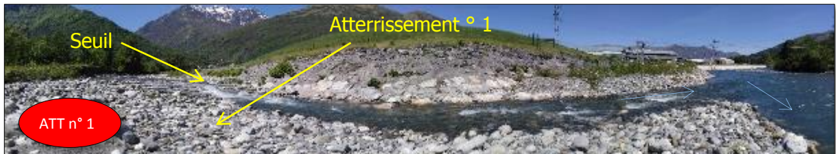
Figure 40 : Seuil de raccordement en amont immédiat de la confluence semblant indiquer une érosion régressive provenant de l'abaissement du gave
