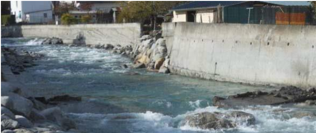
Figure 58 : Rupture et réparation d'urgence d'une digue - Gave de Cauterets - Pierrefitte Nestalas (65) - 2013 (ONF-RTM)
