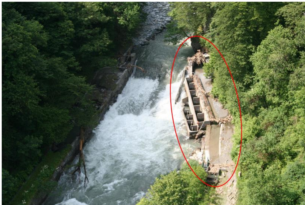
Figure 29 : Vue aérienne post-crue de 2013 de l'ouvrage de prise d'eau en rive gauche du seuil Berty
