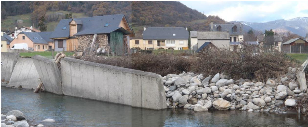
Figure 49 : Rupture du tronçon GC 47.2 en 2012
