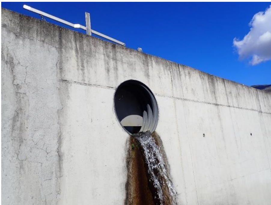
Figure 37 : Ouvrage traversant vanné sur le tronçon GC 47.2
