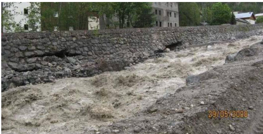
Figure 57 : Affouillement en pied de digue - La Valloirette - Valloire (73) - Mai 2008 (ONF-RTM)
