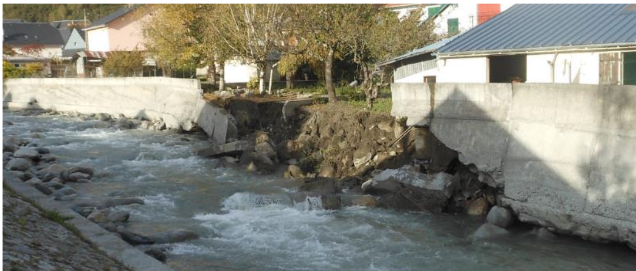
Figure 50 : Rupture du tronçon GC 45bis en novembre 2013
