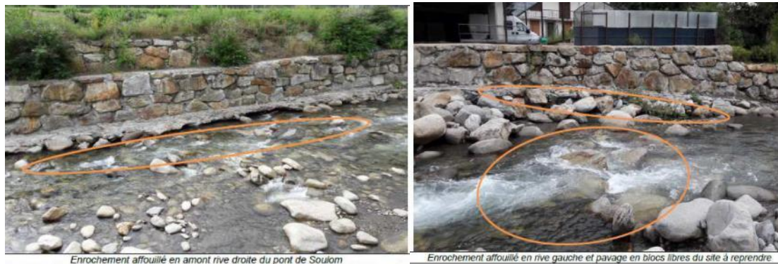
Figure 43 : Désordres observés par suite de la crue de juin 2018 sur les tronçons GC 31.1 et GC 28 (PLVG)
