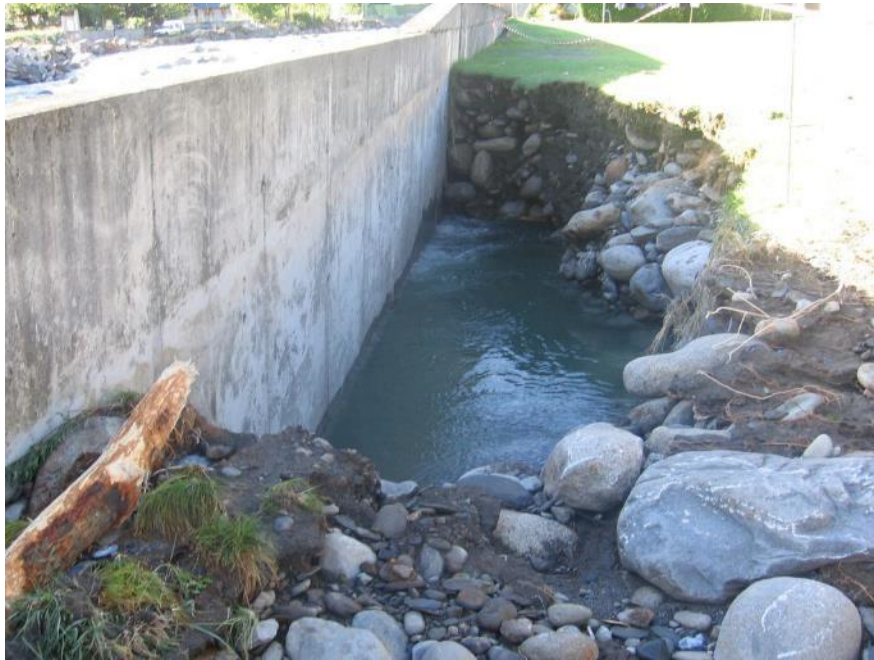
Figure 54 : Renard hydraulique sous la digue en rive gauche à Pierrefitte-Nestalas en 2012
