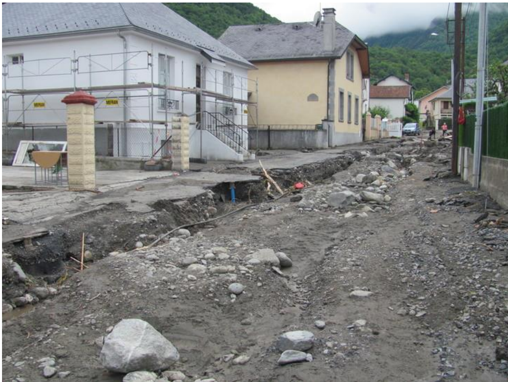
Figure 46 : La rue Boileau après la crue de juin 2013
