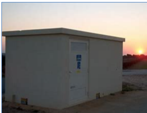
Source : Énergies des territoires
