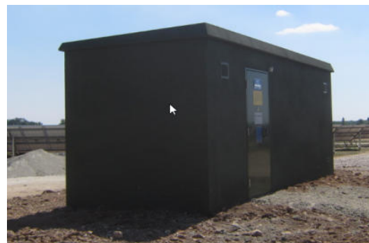
Exemple de poste de transformation
