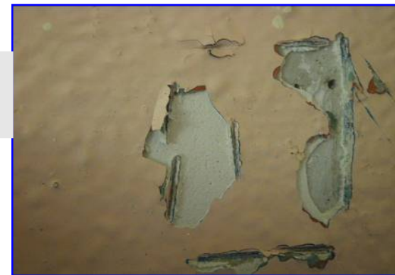
Enduits plâtre anti-bullage amianté
