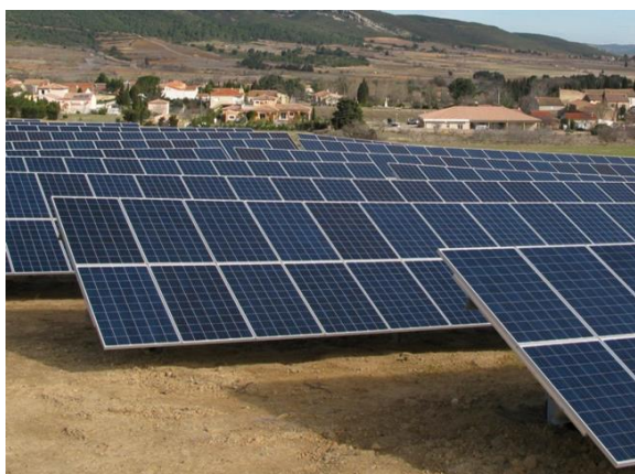
CENTRALE AU SOL THEZAN-DES-CORBIERES
