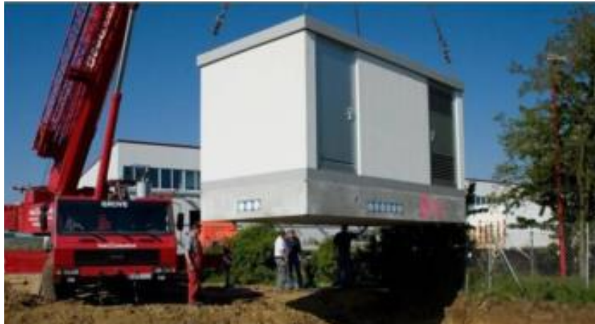
Figure 79 : Livraison d'un local technique
