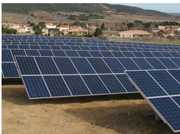
CENTRALE AU SOL THEZAN-DES-CORBIERES
