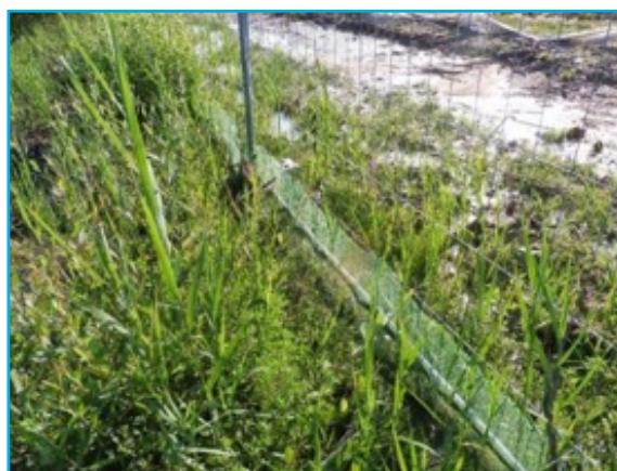
Filet amphibiens en doublement d'une barrière de chantier de type Heras
