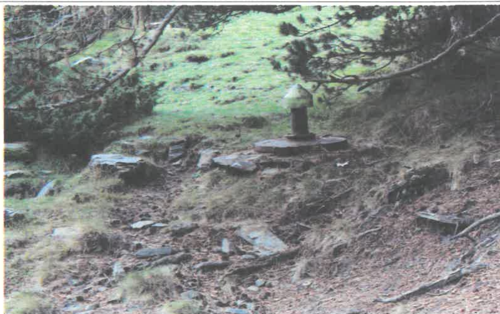
Le passage des randonneurs érode la pelouse naturelle et creuse une 'tranchée' en bordure du brise-charge dont les pierres de parement, servant à l'intégrer dans l'environnement, se détachent
