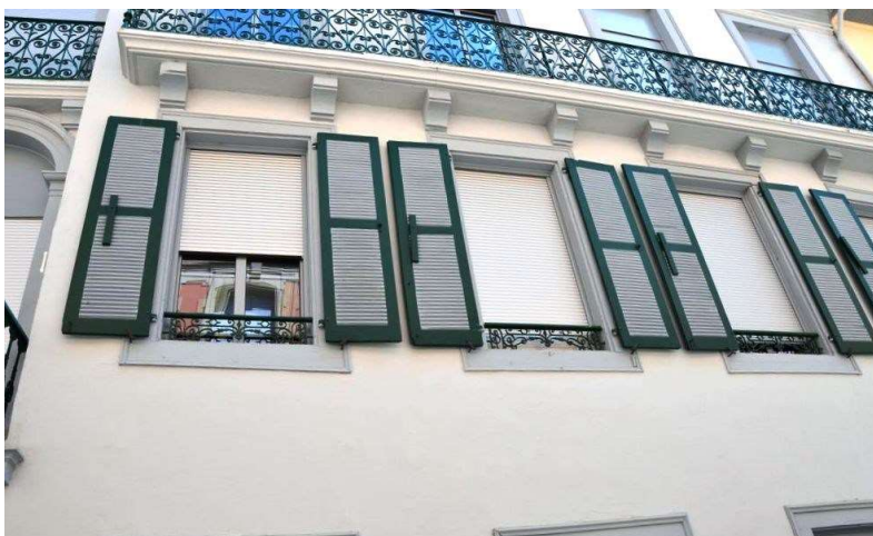
Un système de double fenêtre qui emprisonne une lame d'air isolante est préférable à un système de double volets
