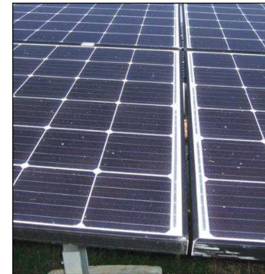
Figure 17 : Espacement entre deux modules Source : Hespul
