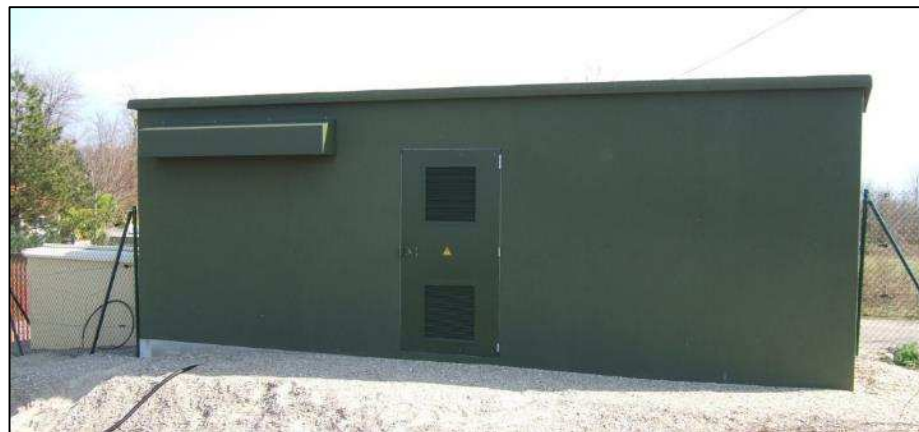
Figure 26 : Exemple de poste de livraison posé sur remblai
