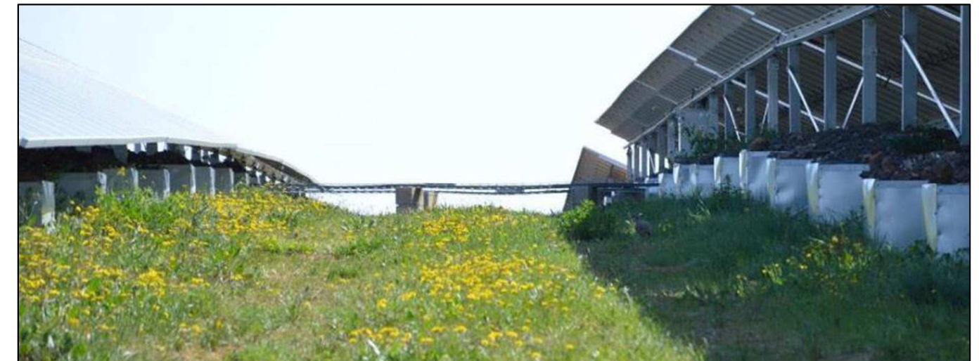
Figure 23 : Exemple de chemin de câbles aérien entre deux rangées de modules
