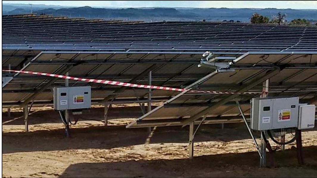
Figure 20 : Exemple d'onduleurs décentralisés de 60 kW situés sous les rangées de modules
