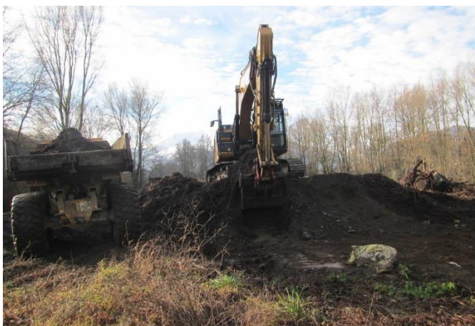
Exemple : Destruction du remblai (PLVG)
