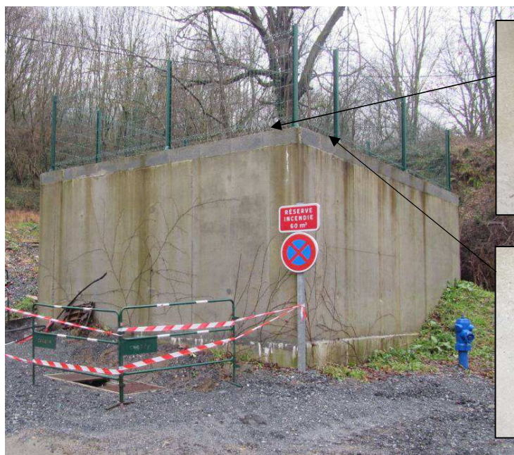
Réserve hors-sol en béton préfabriqué avec PA type H
