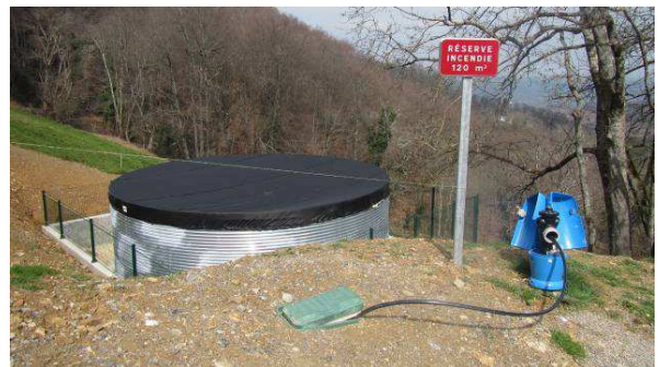
Réserve 120 m 3 avec PA de type S et remplissage depuis le réseau d'eau
