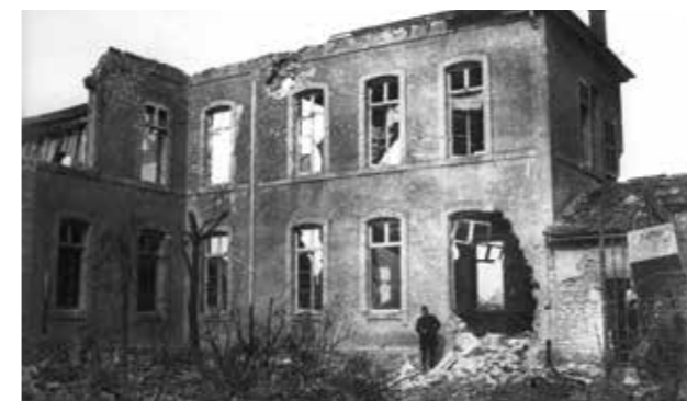
Pont-à-Mousson bombardée, maison en ruines
